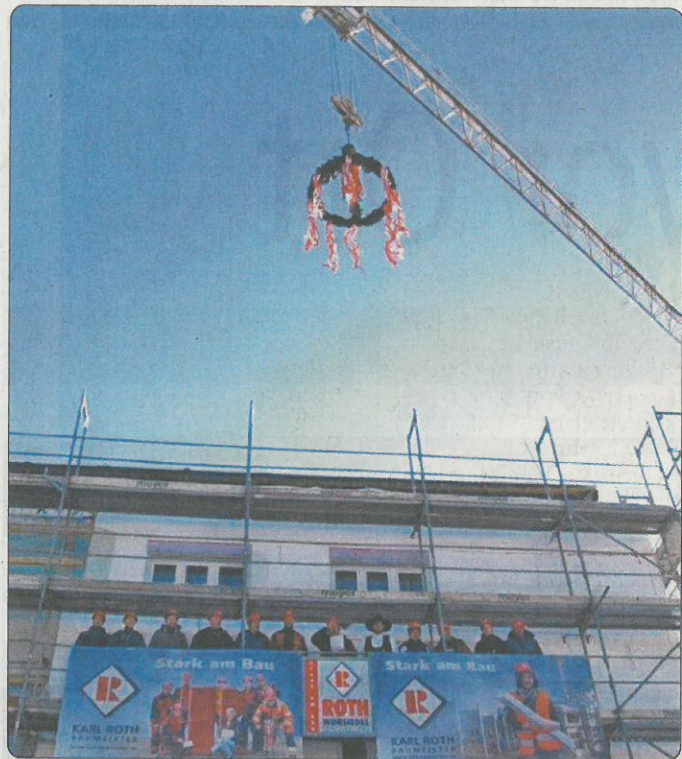
Richtfest im Stadtzentrum: Von einem „besonderen Haus, das ohne Öl und Gas kommt aus“ sprachen die Handwerker beim Richtspruch hoch oben am Gerüst in eisiger Kälte.
