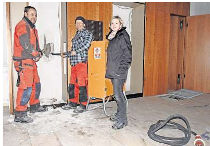
Daniel Köstler (links) und Frank Burger begannen gestern offiziell mit den Abrissarbeiten. Mit auf dem Bild die Geschäftsführerin des Bauunternehmens Roth, Veronika Sirch.
